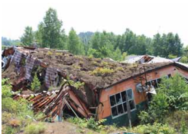
被災した建物 1
