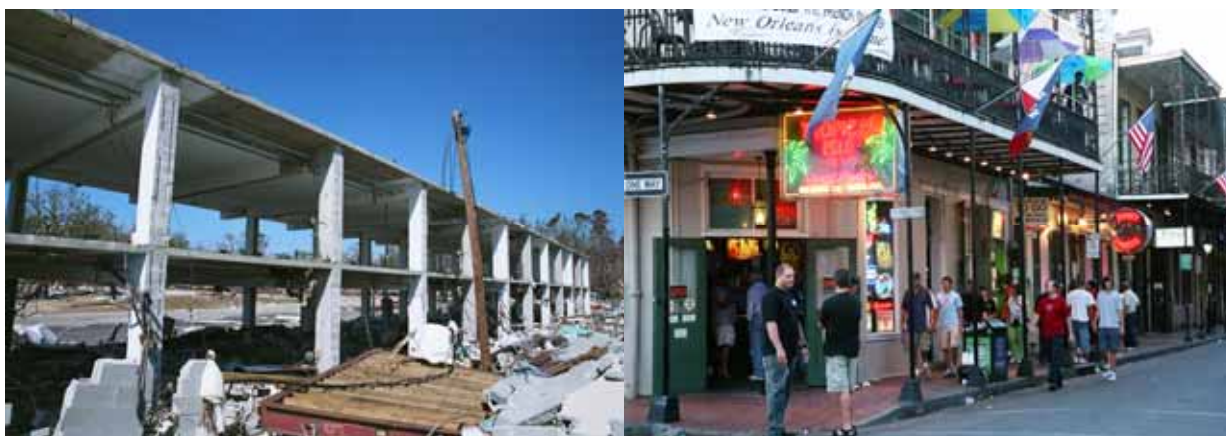
ハリケーン・カトリーナによる被害
